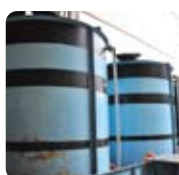
塩水タンク 洗濯機の洗濯槽上部に注入されている塩水を回収した後に保管する専用タンク。
