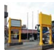
放射線検知ゲート ゲート式の放射線検知器。トラックでの入出荷における放射線測定に用いる。
