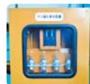
ガス検知器 プレス機での圧縮加工時に圧縮原料からガス漏れが発生していないか検知・監視する。
