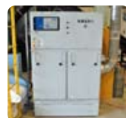
集塵機 作業環境を良くするため破碎・選別等で生じる粉塵を吸い取る。
